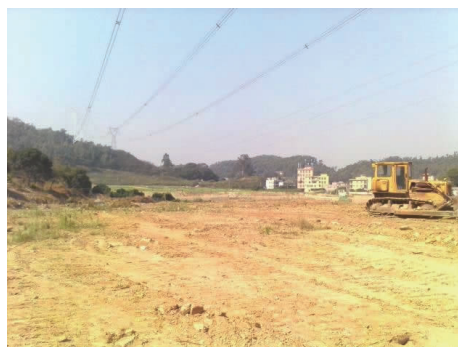
图5 立交南侧高压电力架空线之实景
