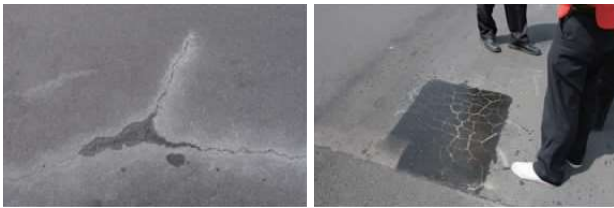
图4 2016年上行三车道铺装损坏情况
