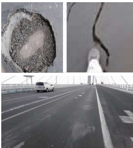
图5 2016年下行车道铺装损坏情况
