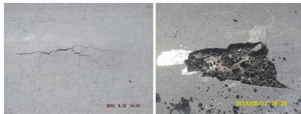
图2 2013年桥面裂缝和坑塘情况
