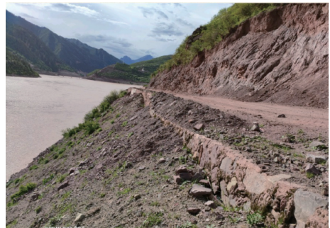
图3 路肩墙整体沉降破坏
