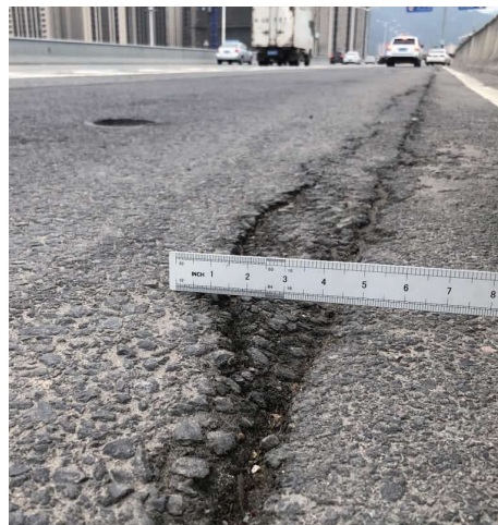
图3 拼接处桥面铺装层破损之实景
