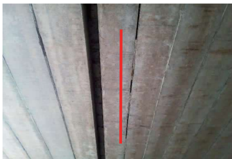
图5 底板开裂之实景
