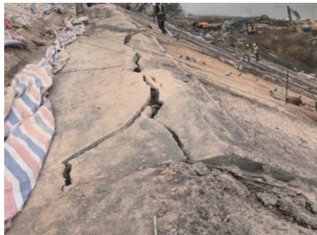
图3 边坡开裂照片
