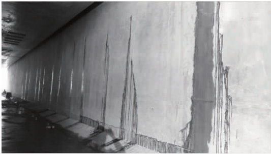
图 3 车站主体结构渗漏水严重
