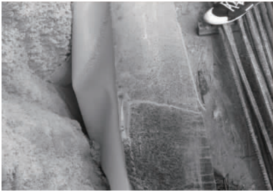
图 2 卷材与基坑侧壁间存在脱空现象
