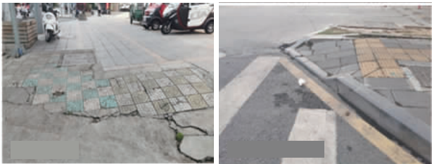
(a) 人行道破损 (b) 无障碍坡道过陡
