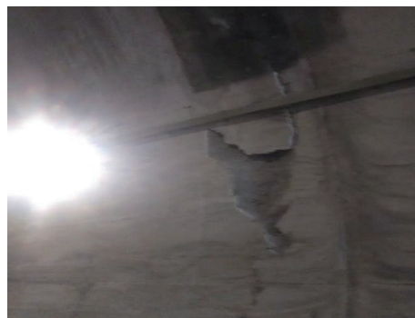
图 7 YK35+268 右洞二衬混凝土掉块
