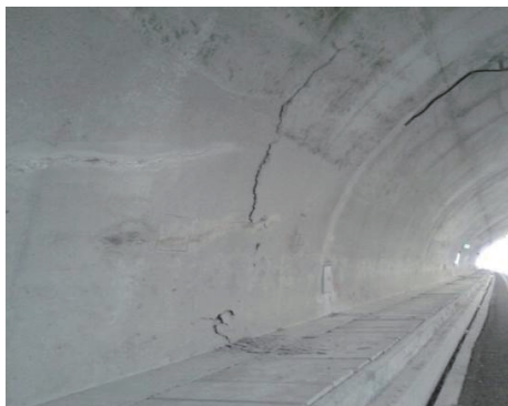
图 4 K35+168 段衬砌开裂
