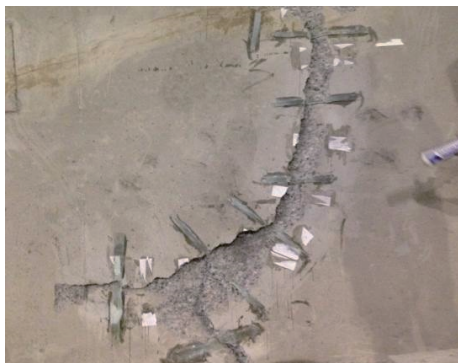
图 5 K35+168 段衬砌开裂处观测玻璃条断裂
