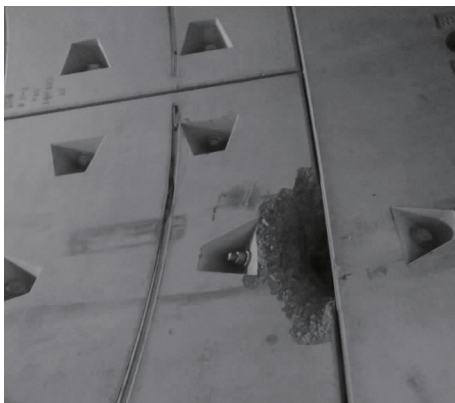
图 4 管片掉块破损
