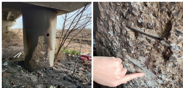
图2 过火桥墩现场灾害图
