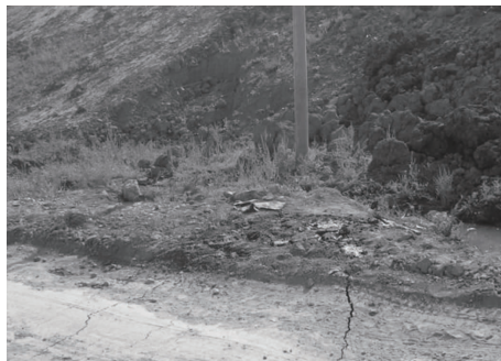
图2 上海某公园景观堆土施工过程中发生的坡脚隆起
