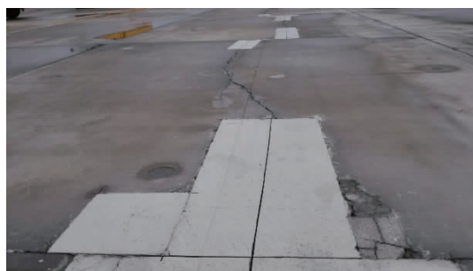
图3 损坏板状况之实景
