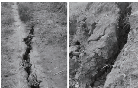
图 3 开挖坡面上部拉张裂缝之实景
