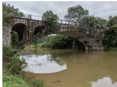
图1 桥头湾桥加固前
