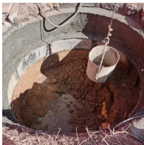
图3 桩位下发现燃气管
