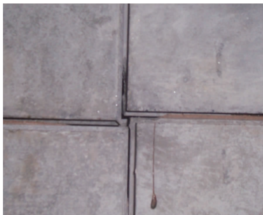
图1 盾构施工中产生的错台
