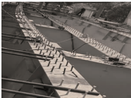
图 3 钢箱梁整体扭转(外缘下沉)
