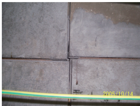
图 1 施工现场产生的一个典型的错台之实景
