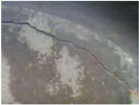
图 2 管道破裂、渗漏图示
