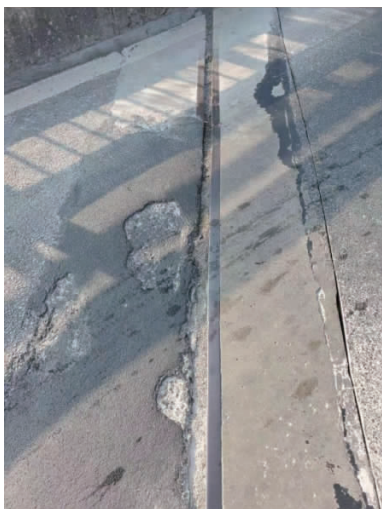
图6 桥梁伸缩缝病害现状
