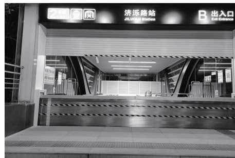
图2 济南地铁北园站出入口电动防淹门
