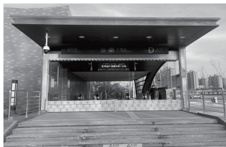
图1 济南地铁王府庄站出入口防淹挡板
