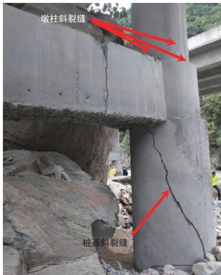
图 3 右侧桩基斜裂缝
