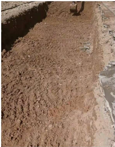
图 3 塌陷区原填料图
