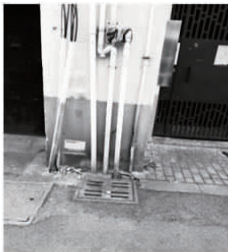
图6 雨污混接现场照片
