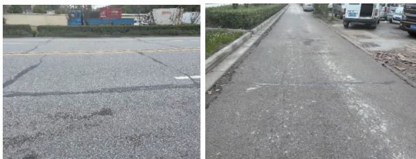
图3 华腾公路原沥青混凝土路面状况
