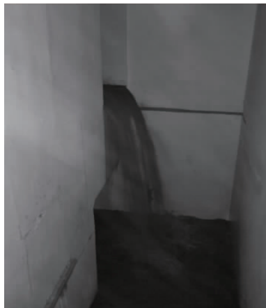
图5 管廊引出线口暴雨倒灌之实景
