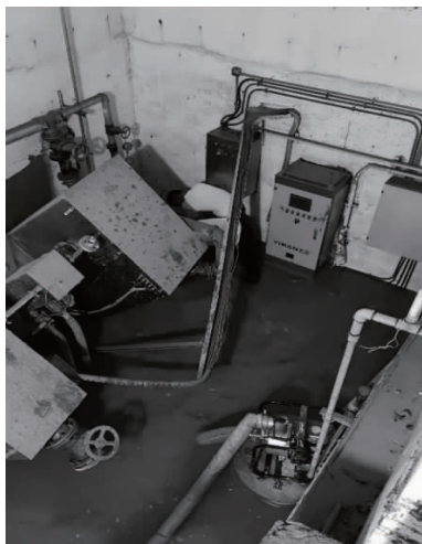
图8 雨水泵房内设备受损之实景
