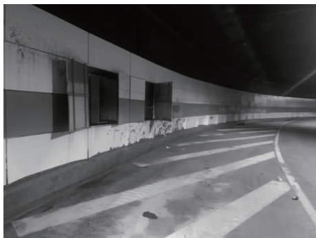
图6 搪瓷钢板变形之实景
