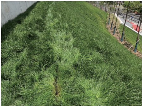
图2 现场坡顶裂缝
