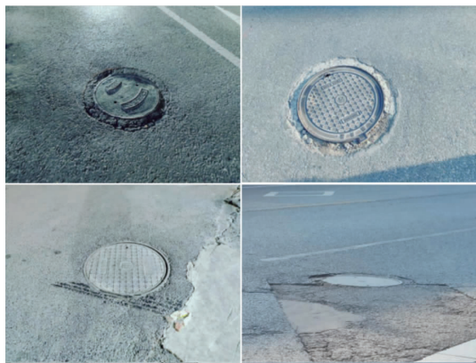
图 2 检查井常见破坏形式图示
