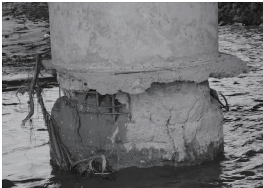
图 4 桥墩基础冲刷病害现场实景
