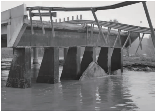
图 3 7# 桥台肋板台身完全裸露实景
