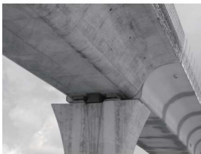
(a)箱梁断面突变照片
