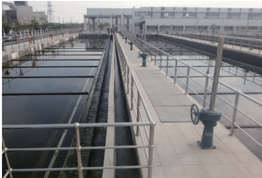
图1 广州市前锋净水厂(扩建三期)周进周出二沉池变截面配水渠
