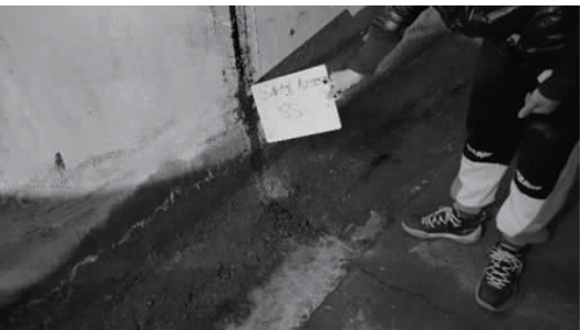
图 22 江苏大道综合管廊渗漏水
