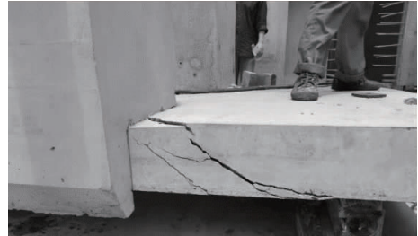
(b) 护栏端部桥面板扭转裂缝
