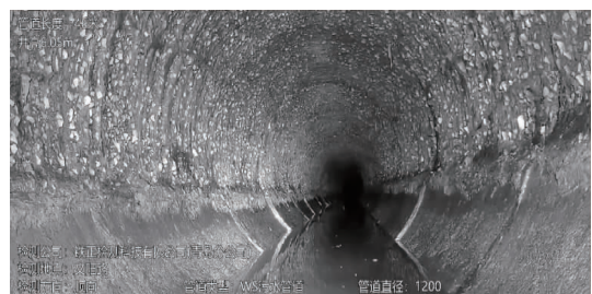
图 4 排水管道结构性缺陷修复前检测图
