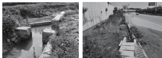
(a)涝淄河排河口断面狭窄 (b)乌河1号排洪沟排河口阻断
