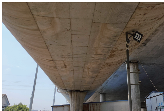
图 2 桥梁病害照片
