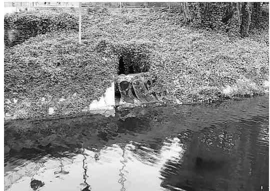
图3 排水口拦污装置
