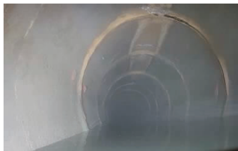
图5 DN2000 雨水管道缺陷点影像图 2
