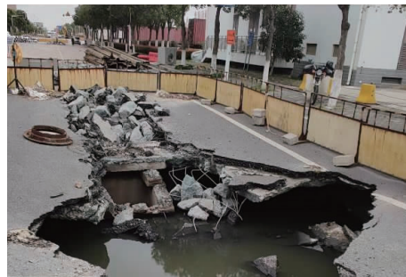
图 1 道路路基脱空引发的路面坍塌实例
