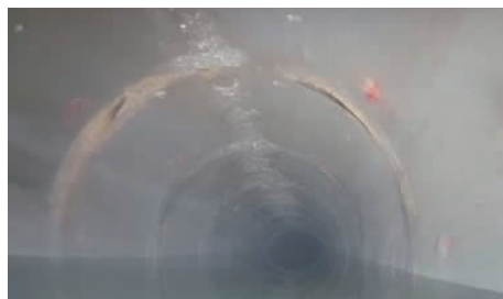
图4 DN2000 雨水管道缺陷点影像图 1
