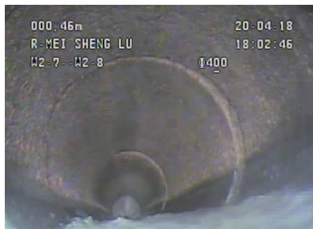
图3 DN400 污水管道缺陷点影像图
