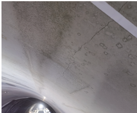
图5 隧道二衬纵向裂缝现场照片
