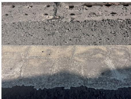
图 2 旧标线老化开裂
