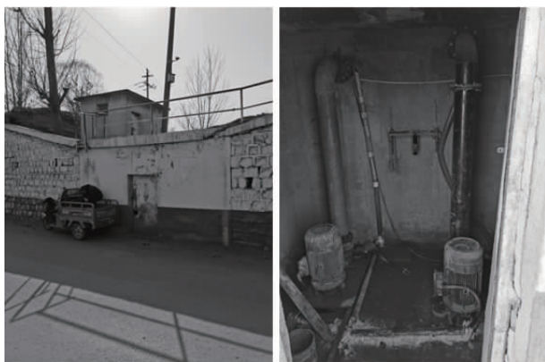
图 5 年久失修的雨水泵站
