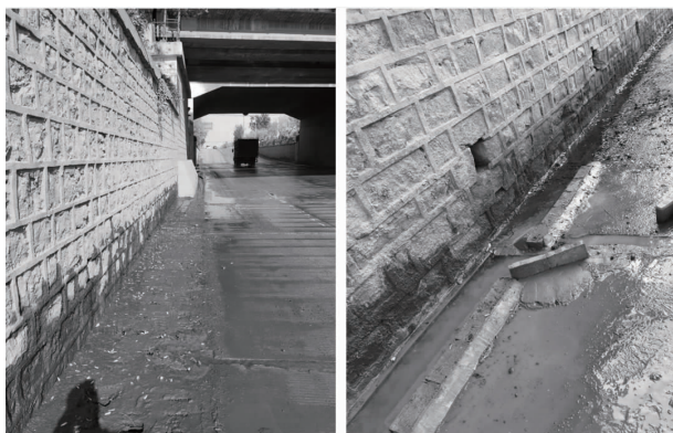
图 6 铁路桥下不断渗出的地下水
