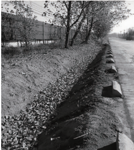
图 2 冯北路东侧现状边沟
