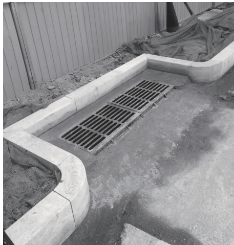
图17 冯北路港湾式雨水口
