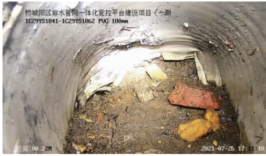
图2 管道淤堵破裂
