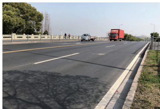
(注:示范应用桥梁范围的路面状况优于相接道路)
