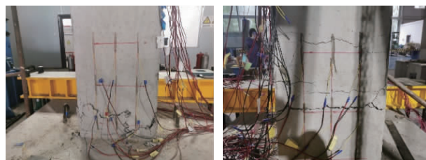
(a)现浇方柱破坏 (b)钢混组合连接方柱破坏
