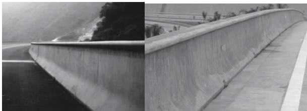
图9 阻爬坎+新泽西型混凝土护栏
