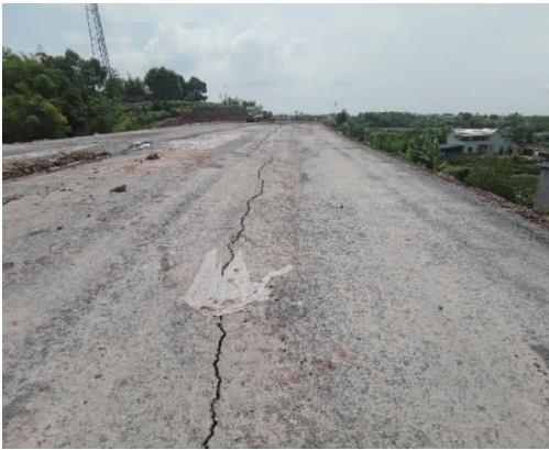
图 2 5 月 13 日路基右侧中部纵向裂缝图
