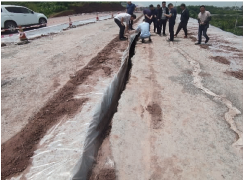
图3 5月16日路基右侧中部纵向缝扩展图
