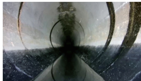
图5 管道接口渗漏
