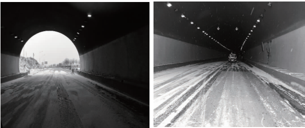
图1 隧道进口路面积雪状况
