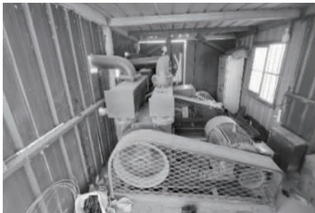
图 2 55 kw 节能真空泵(一备一用)
