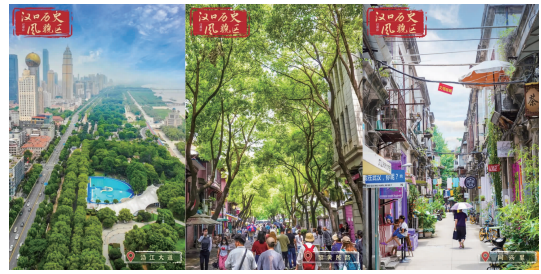
图10 各类道路全要素改造完成后的现场照片 (a)沿江大道 (b)黎黄陂路 (c)同兴里
